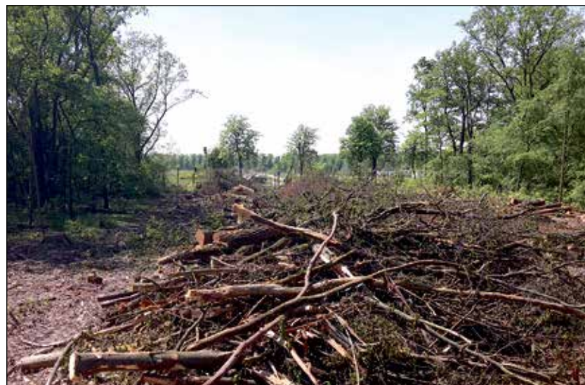
An der B179, Höhe Einmündung Halskestraße, entsteht die Hauptzufahrtstraße zum Entwicklungsgebiet auf dem Funckerberg.
