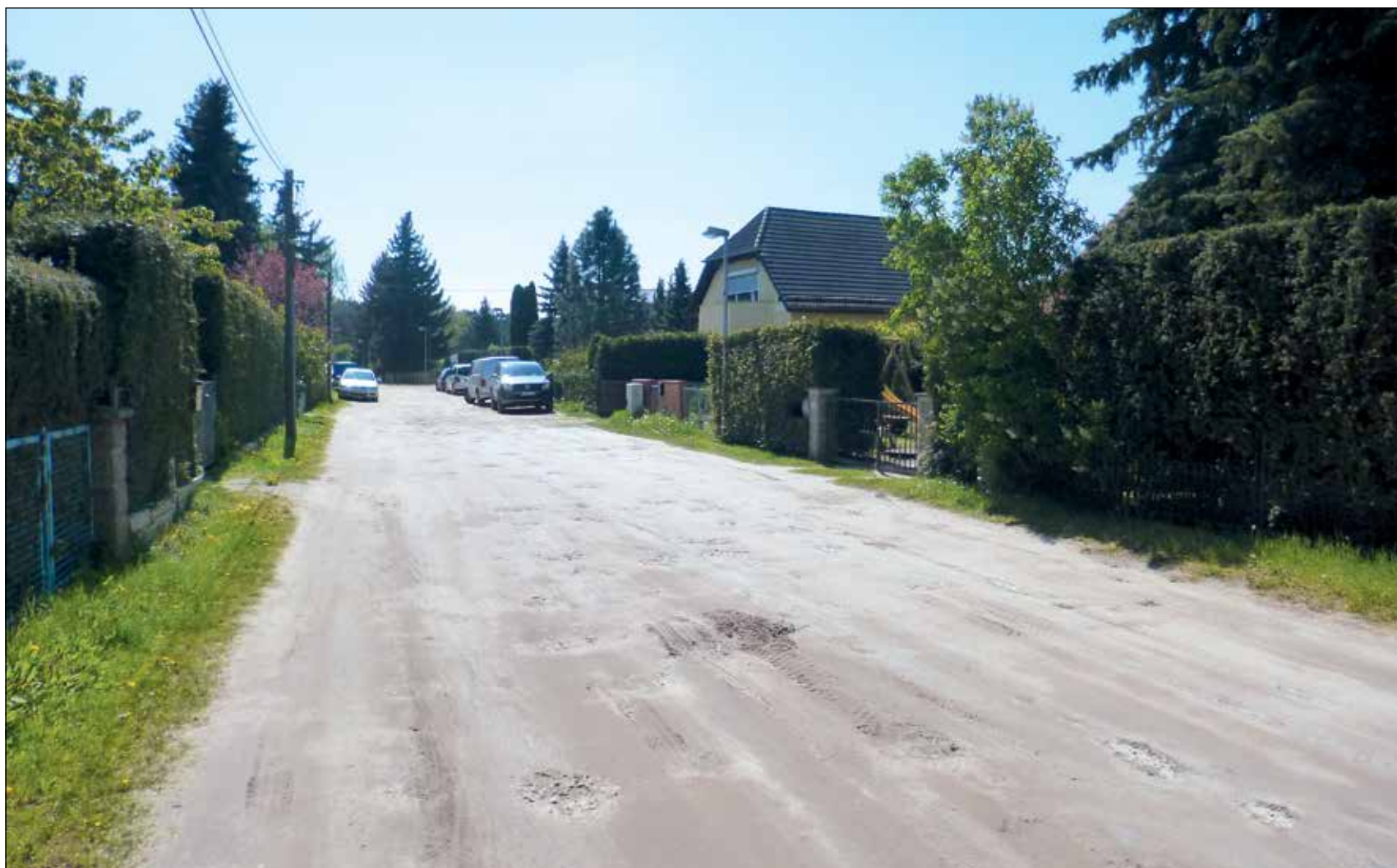
Brunhildstraße Senzig: Die „Fahrbahn“ mit Schlaglöchern übersät und erstreckt sich fast über die gesamte Breite zwischen den Grundstücken. „Grüne“ Seitenbereiche mit Entwässerungsmulden sind praktisch nicht vorhanden.
