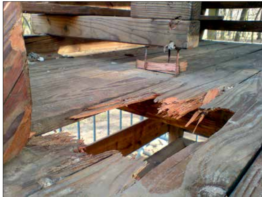
Die Stadt gibt viel Geld für die Beseitigung von Vandalismusschäden aus
