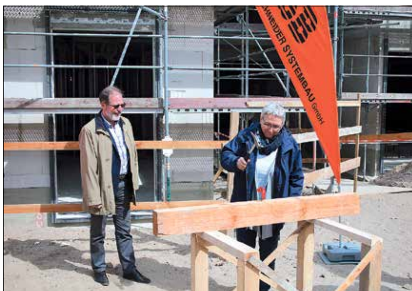
Tradition auch beim Richtfest für die neue Kindertagesstätte in der Rosa-Luxemburg-Straße: Petra Brückner von der Kita „Spielspaß“ schlägt einen Nagel in einen Holzbalken. Die „Spielspaß“-Kinder werden noch dieses Jahr in den Neubau einziehen. Fotos: Reik Anton
